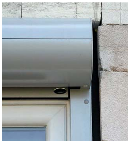
Dieser Vorbau-Rollladenkasten erfüllt den Ausnahme-Tatbestand der Richtlinie nicht!
