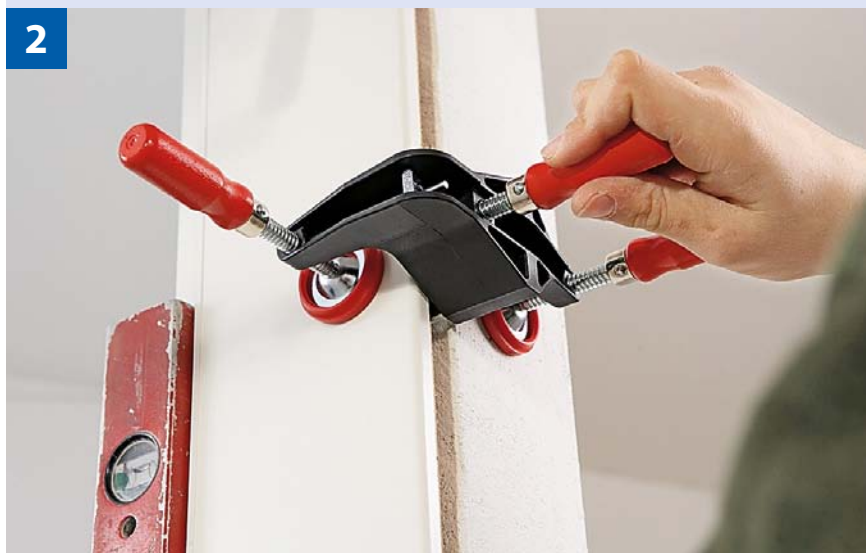
2 Mit der Türfutter-Richtzwinde „TFM“ richtet man nun das Türfutter aus und fixiert es im Wandausschnitt.
