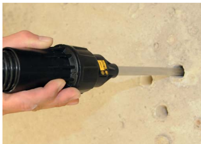
Mit der Absaugdüse lässt sich das Bohrloch problemlos aussaugen. Vor allem Chemiedübel und -anker halten in staubfreier Umgebung extrem fest.
